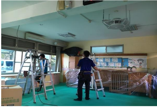
嬰幼兒家園施工空氣清淨系統
