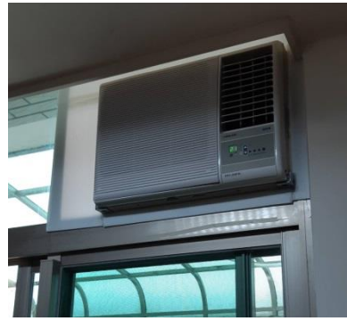
中途之家新增冷氣機，讓空間避免悶熱
